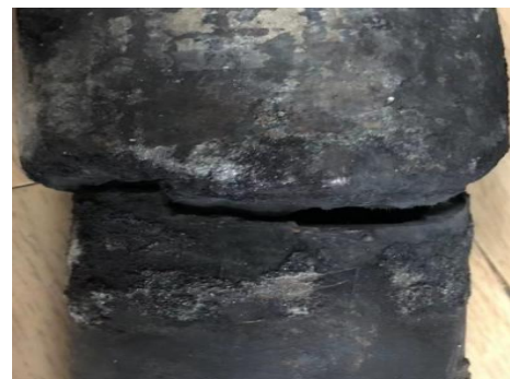
图 2 环焊缝一侧的环向开裂形貌
