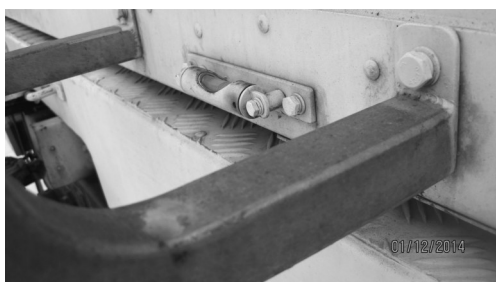
图1 车梯腐蚀照片(材质:304不锈钢)
