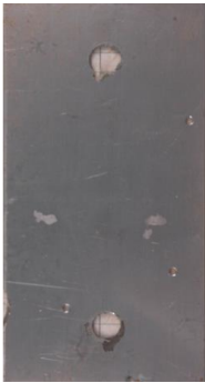
图 5 0Cr13 在三门峡水库中暴露 8 a 的外观
