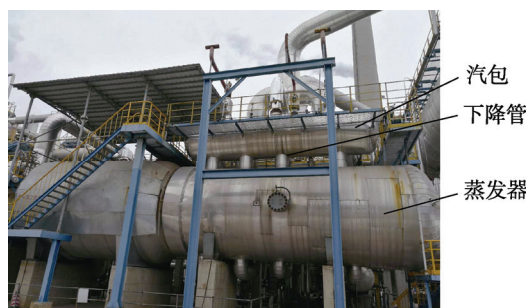
图 3 石化装置反应器蒸汽发生器
