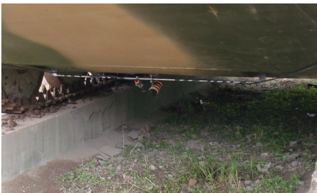
图 12 富春江实验接收水听器的固定安装
