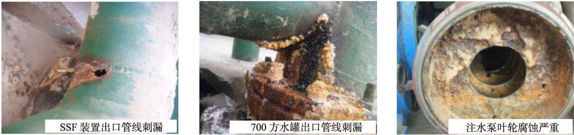
图 2 污水处理系统腐蚀情况 Fig.2 Corrosion of sewage treatment system
