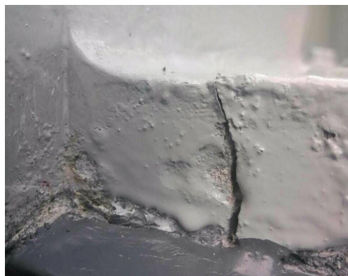
图 5 腐蚀裂纹 Fig.5 Corrosion crack
