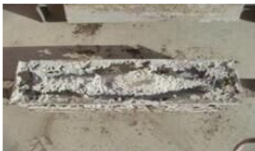
图 1 镁阳极腐蚀严重照片
