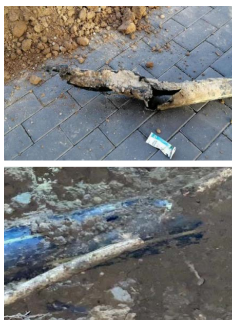
图13 电缆短路导致PE管熔化烧结
