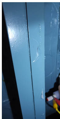
图5 非重要承力框梁的防护涂层表层起皮的典型外观照片
